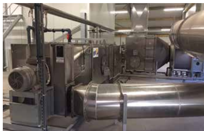
De ventilatoren bij Biogas De Biezen
